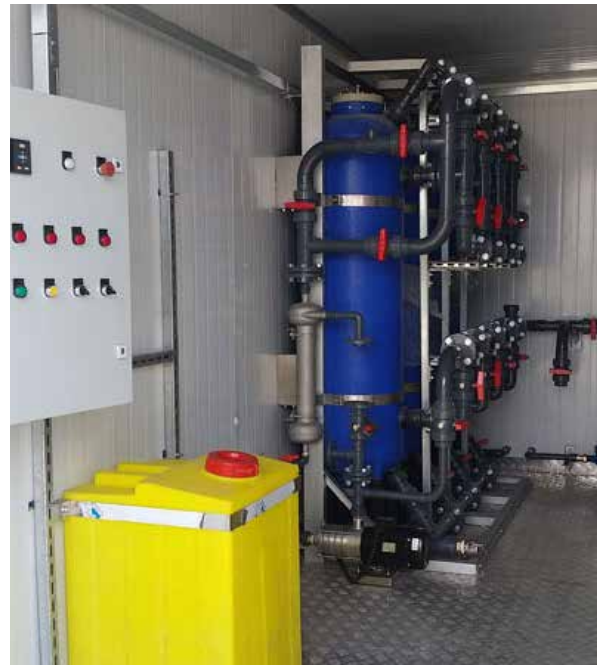
Containerbaserad vattenreningsenhet - SC100 - med en kapacitet av 100-170 m 3 /dygn, manuell drift.
