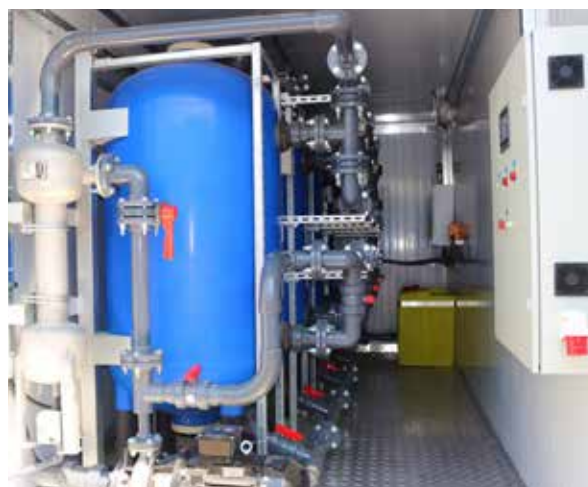
Containerbaserad vattenreningsenhet - SC500 - med en kapacitet av 400-650 m 3 /dygn, manuell drift.
